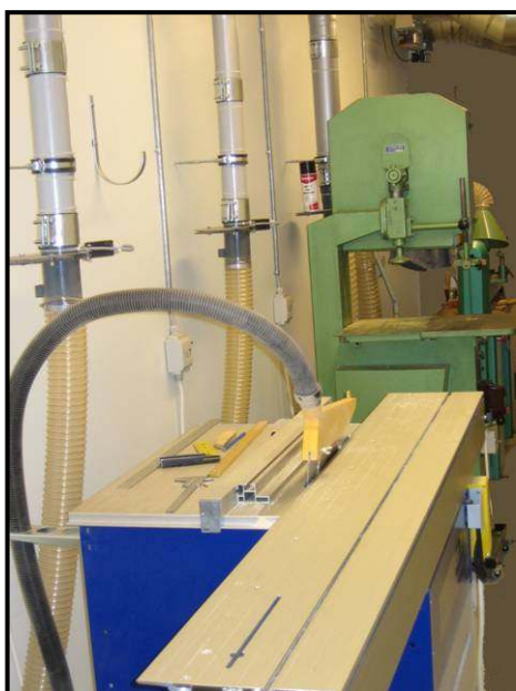
Udsugning fra maskiner
